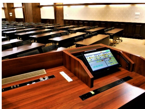
操作卓 CVASタッチパネル
